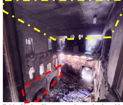
Eski Köşk Sineması: Sarı alanda eklenti betonarmeler kaldırıldığında iç avlulu etrafında odalar görülmektedir.
