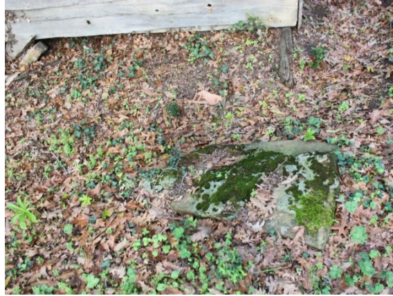
Şekil 27. Camii güneydoğu köşesinde döşeme altından kayan taş kaide.
