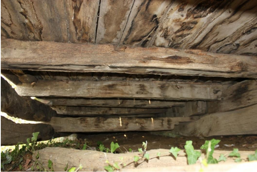
Şekil 15. Camii batı koridor altındaki döşeme kirişleri (Kahraman ve Boduroğlu, Ekim 2015)
