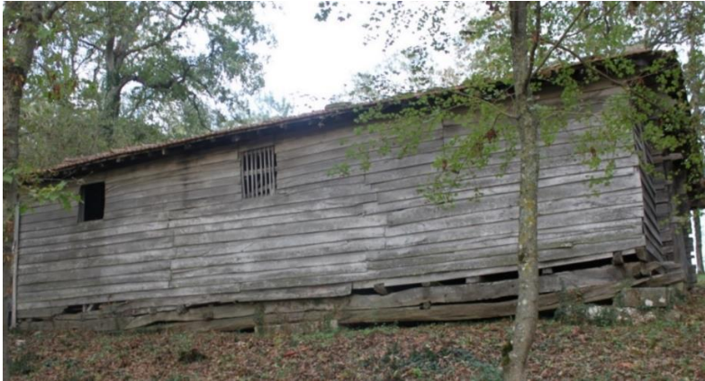
Şekil 17a: Işıklı Camii batı cephesi döşeme kirişleri altındaki taş kaideler (Kahraman ve Boduroğlu, Ekim 2015)
