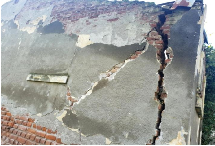
Figür 9. Doğu duvarındaki yapısal çatlak
