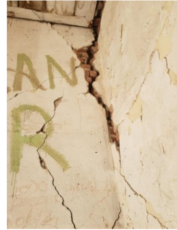
Figür 10. Kuzey duvarındaki yapısal çatlak
