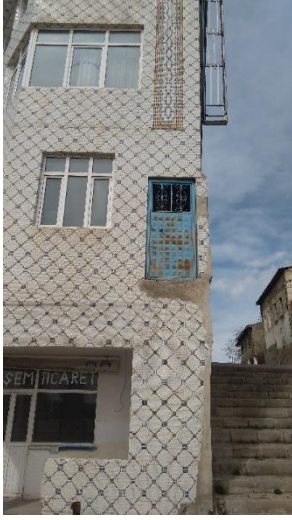
Res. 18: 40 No'lu koridorun bitişindeki zemin kodu oynaması (Boşluğa Açılan Demir kapı)
