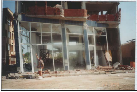
Şekil 2. Zayıf kat hasarı [2]
