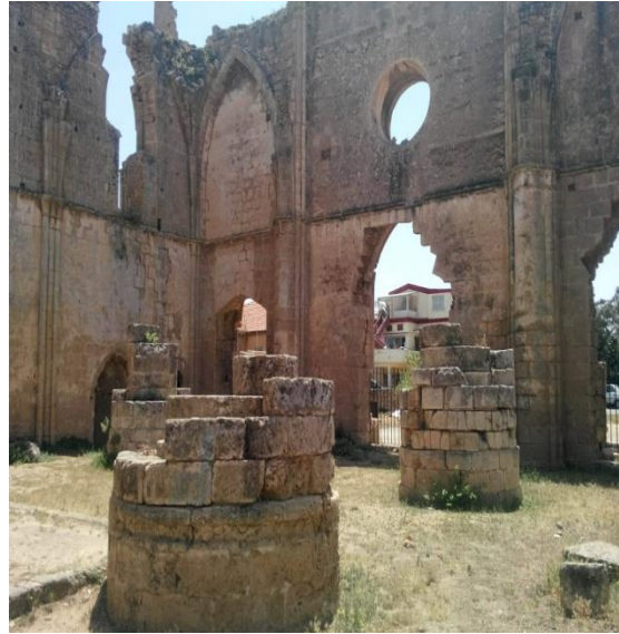
Şekil 9. Gazimağusa Kaleiçi St. Nikolas Katedralindeki yapı taşlarında görülen büyük parça kayıpları
