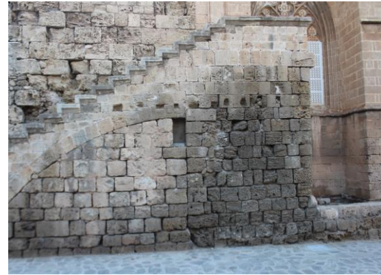
Şekil 13. Gazimağusa Kaleiçi Lala Mustafa Paşa Camiisi güney cephesindeki yapı taşlarında su-nem etkisi ile oluşmuş renk farklılıkları
