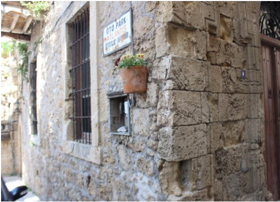
Şekil 15. Gazimağusa Kaleiçi kale surları ön cephede tuzların oluşturduğu erozyon
