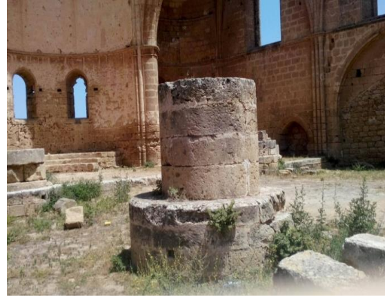
Şekil 21. Gazimagusa Kaleiçi yapı taşları üzerindeki otsu bitkilerin oluşturduğu hasarlar
