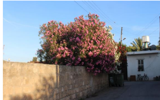
Şekil 22. Gazimagusa Kaleiçi duvarlarındaki yüksek bitki damarları zamanla taş duvarı hasara uğrattığı
