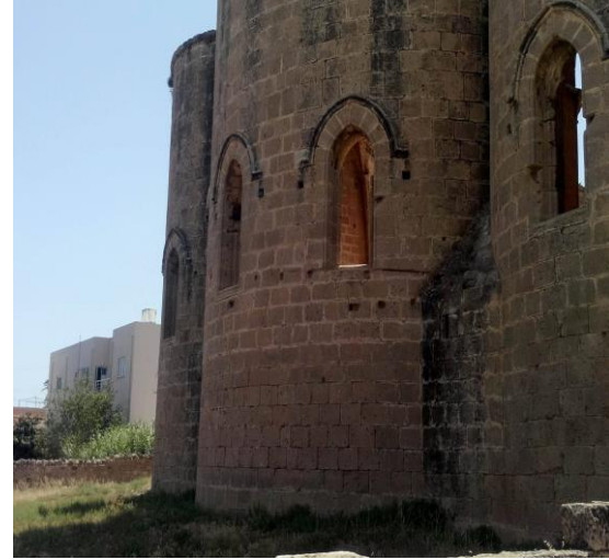
Şekil 12. Gazimağusa Kaleiçi Lala Mustafa Paşa Camiisi güney cephesinde yapı taşlarında görülen siyah lekelenmeler
