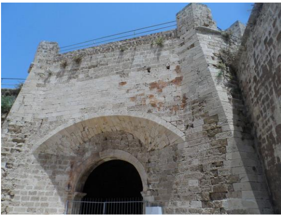
Şekil 16. Gazimağusa Kaleiçi kale surları ön cephesindeki yapı taşlarında tuz etkisi ile oluşmuş aşınmalar
