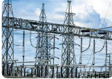
Görsel 2.121: Elektrik nakil hatları
