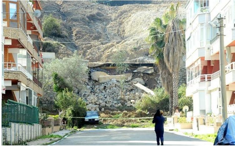
Şekil 3. 2019 yılında meydana gelen heyelan nedeniyle yıkılan istinat duvarı [17].
