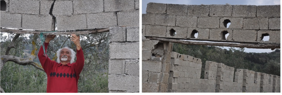
Resim 4. Antakya'da deprem, ovada büyük bir yıkıma yol açarken, hemen bitiştikteki sağlam zemindeki yapılara hasar vermemiştir; derme çatma yapılmış ancak zemini sağlam metruk ahır çarpıcı bir örnek olarak hala ayakta.
