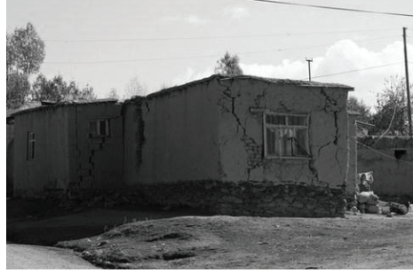
Şekil 4. Van-Döşeme Mezrası'nda hasarlı bir yığma yapı örneği (Parsa 2011)
