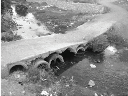
Şekil 2. Dere yatağına kaçak olarak yapılan enine yapı
