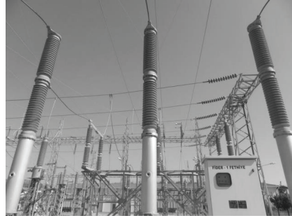
Şekil 12. Silikon kaplanan şalt teçhizatları
