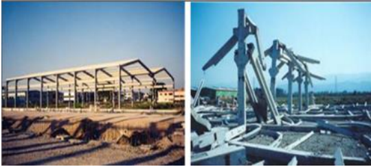
Şekil 4. Marmara depremi etkisine maruz kalan prefabrik yapı [10].
