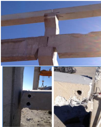
Şekil 7. Çatı makası kirişinin düşerken eğdiği kolon donatıları, prefabrik kiriş ve parçalanmış bağlantı noktası
