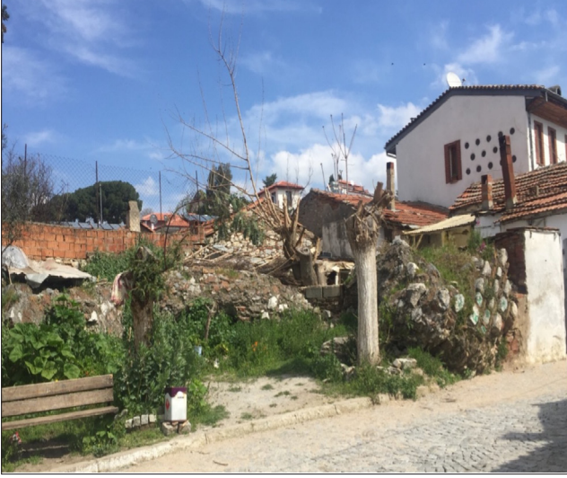
Fotoğraf 2. Selçuk Atatürk Mahallesi 1058 Sokak'ta 7-9 No'lu konutlar arasında bulunan (358 Ada, 187 Pafta, 4659 Parsel) 1. Zaviyeli Cami Eyvanı'nın kubbe kalıntıları. / The remains of the dome of the 1st Zawiya Mosque iwan, located between residences 7 and 9 on 1058 Street in Selçuk Atatürk Neighborhood (358 Block, 187 Pafta, 4659 Parcel).
