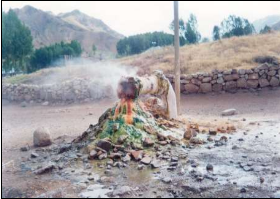
Foto 2: -Taşkapı (Şor) Köyü'nde açılmış jeotermal sondaj kuyularından biri. Çökelen mineral maddeler görülmektedir.
