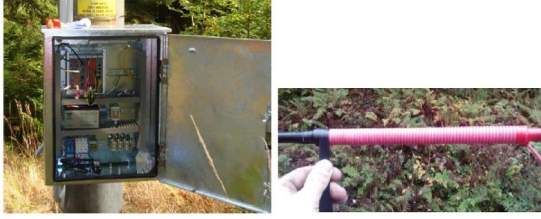
Şekil 2. ENET ölçüm sistemi ve izoleli iletken yüzeyindeki tek katlı bobin.
