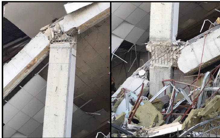
Şekil 23: Kolon-kiriş birleşimlerinde yetersiz etriye kullanımı sonucu, Kahramanmaraş (Kirtel 2023) Figure 23: As a result of insufficient use of stirrups in column-beam joints, Kahramanmaraş (Kirtel 2023)
