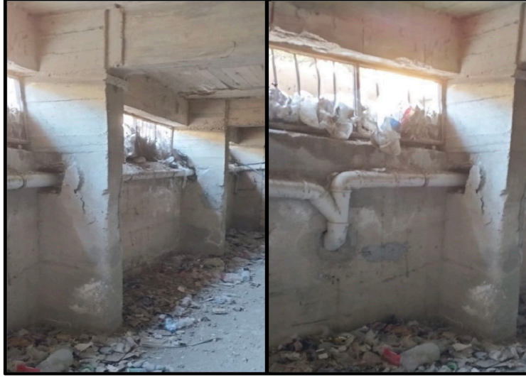
Şekil 24: Taşıyıcı sistem elemanlarına zarar verilmesi, Hatay (TMMOB MO ve İMO İzmir Şb. 2023) Figure 24: Damage to structural system elements, Hatay (TMMOB MO and İMO İzmir Br. 2023)
