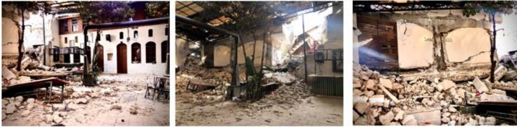
Şekil 14. 115 ve 283 No'lu parsel yapılarının depremden sonra hasar tespiti fotoğrafları (Y. Mimar Deniz Emir Fotoğraf Arşivi, 2023)
