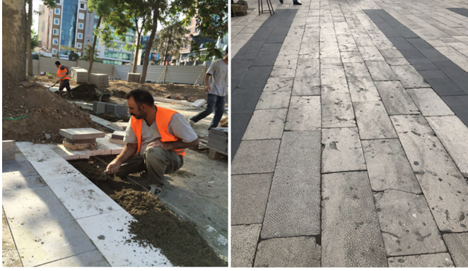
Şekil 2. Elazığ 15 Temmuz Demokrasi Meydanı'nda Kullanılan Doğal Taşların Durumu.
