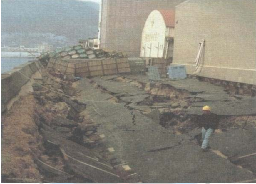
Şekil 4.9. 1995 Kobe depreminde sıvılaşma sonucu oluşan istinat duvarı yenilmesi [15].
