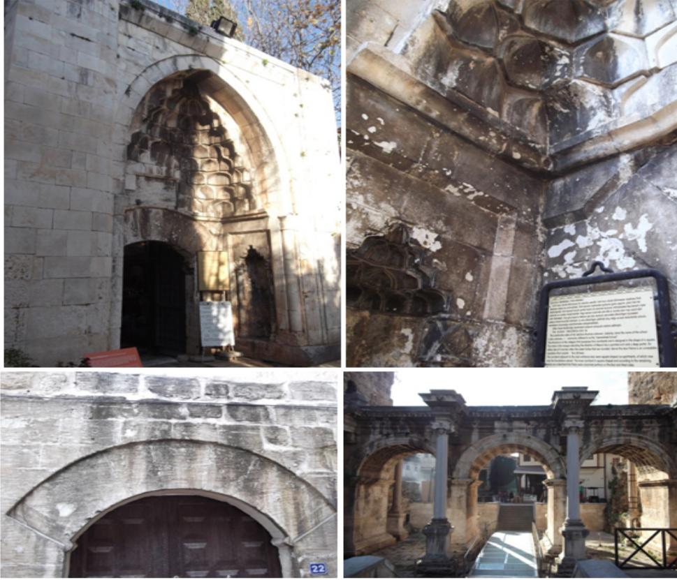
Şekil 8. Özellikle şehir merkezine yakın olan yapılarda sıklıkla görülen atmosferik kirlenme, yoğun şekilde kendini hissettirmektedir.
