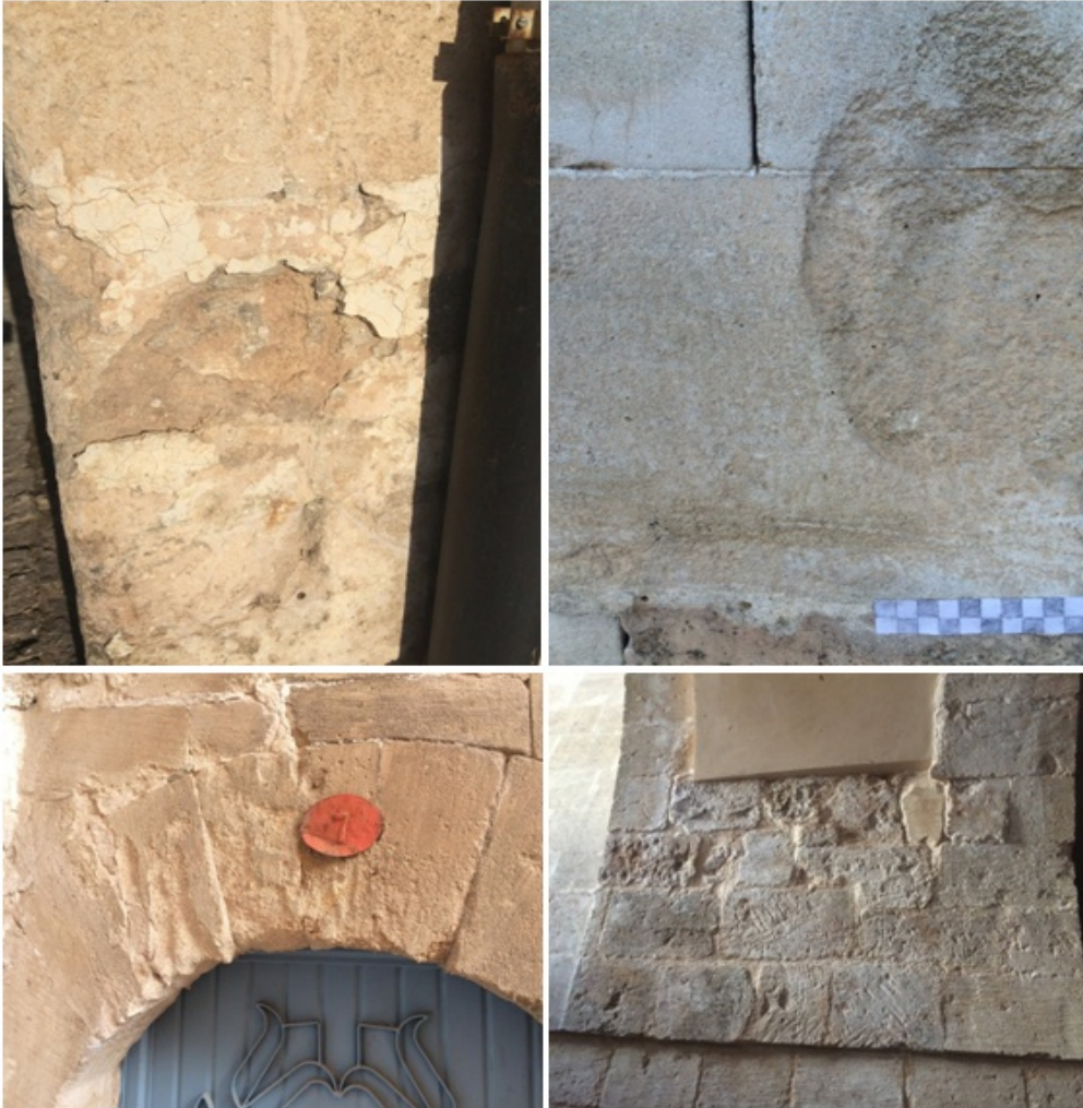
Şekil 2. Sıcaklık değişimleri ve kimyasal ayrışma olayları sonucunda kaya kütlelerinin ince katlar şeklinde taşın yüzeyine paralel levhalar halinde ayrışması (üst-sol), dağılma şeklinde ayrışma (üst-sağ), granüler çözünme (alt-sol) ve alveolar ayrışma şeklindeki materyal kayıpları.
