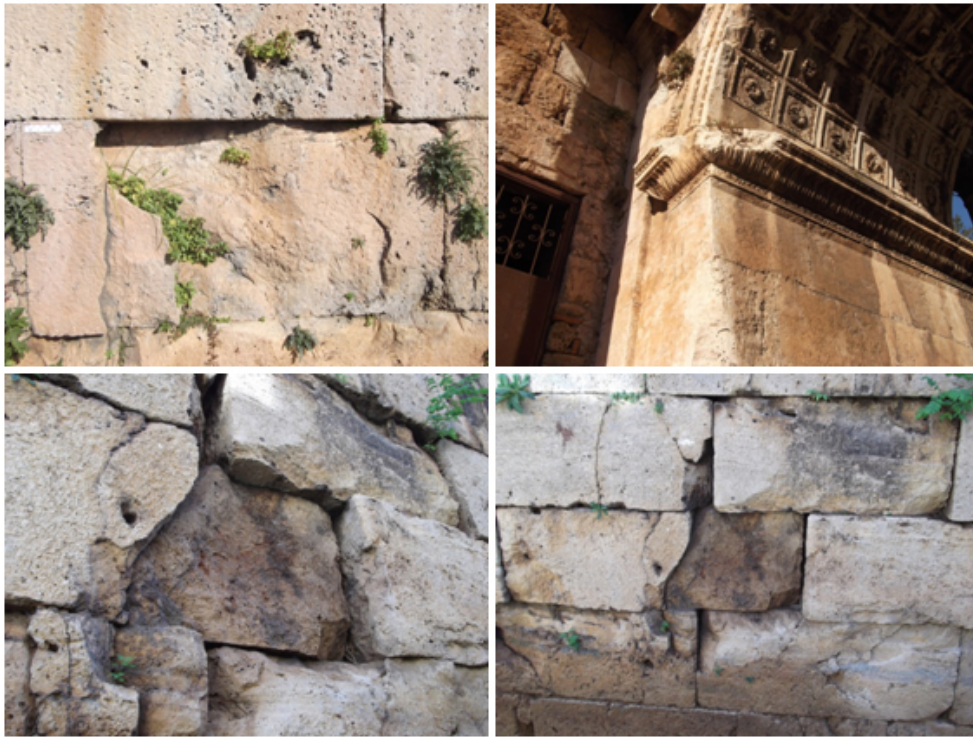
Şekil 3. Mardin’deki bazı yapılarda, yüzeyden materyal kaybı kendini oldukça belirgin şekilde göstermektedir. Bazı yapılarda, taşın iç basıncından dolayı düzgün olmayan parça ayrılması olarak görülen “patlama” şeklindeki ayrışma sonucunda taşın özgün yapısını tümüyle kaybettiği ve binanın duvarlarında zayıflamaya neden olduğu gözlenmiştir.
