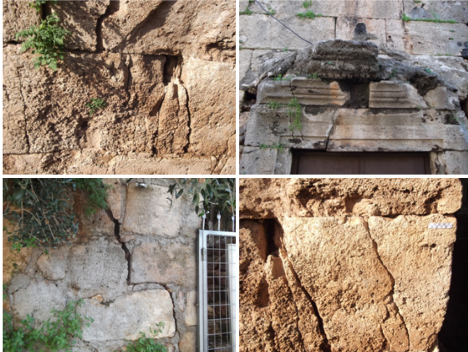
Şekil 6. Mardin'deki tarihsel yapılarda gözlenen, taşta çeşitli nedenlerden dolayı oluşan (kılcal, tek çatlak veya çatlaklar sistemine örnekler.
