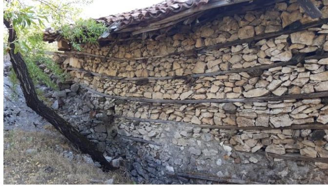
Şekil 21. Yapının doğu cephesinde görülen deformasyonlar.
