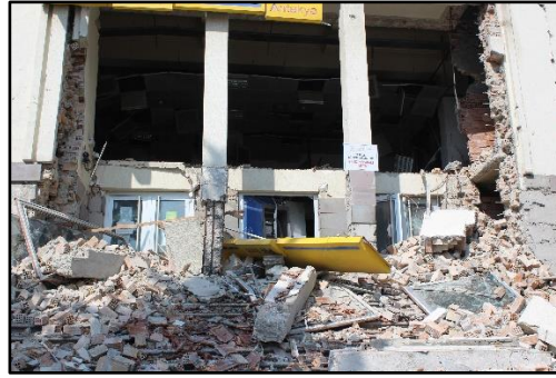
Şekil 1. Kahramanmaraş merkezli depremler (6 Şubat 2023) sonrası oluşan inşaat yıkım atıkları (Antakya)
