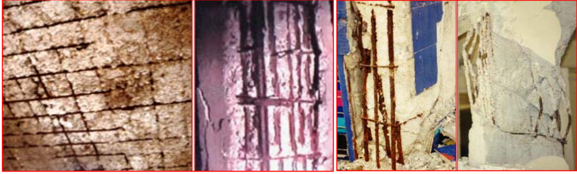
Şekil 8. Korozyona uğramış yapı elemanları
