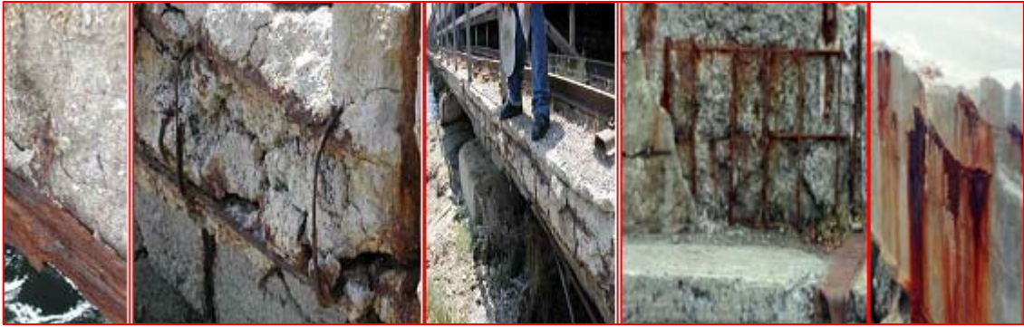
Şekil 3. Deniz kenarında korozyona uğramış yapı örnekleri.
