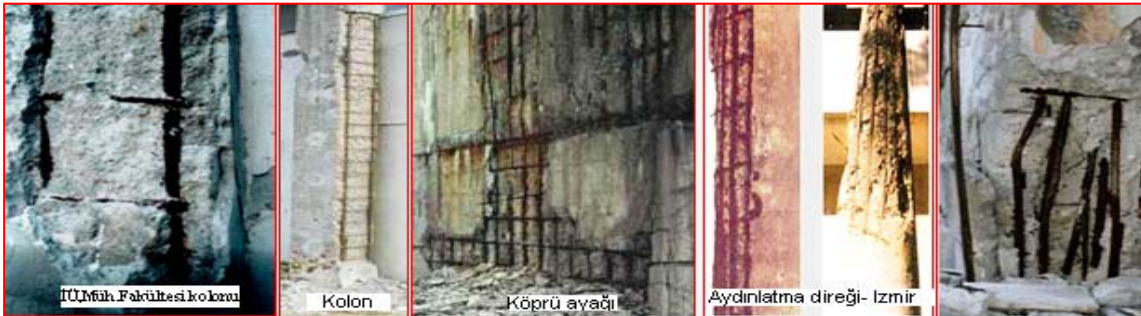
Şekil 2. Korozyon sonuç pas payı betonu dökülmüş örnekler.
