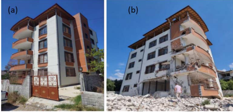
Şekil 25 - Samandağ ilçesinde hafif hasarlı binanın (a) ön cephesi ve (b) yan parselde yer alan binanın çarpması sonucu arka cephesinde yapısal elemanlarda oluşan hasarlar
