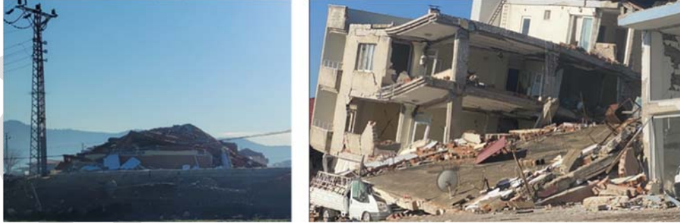
Şekil 18 - Kırsal kesimde az katlı yapılarda gözlemlenen toptan göçme ve ilçe merkezinde sıklıkla rastlanan ağır hasarlı binalar
