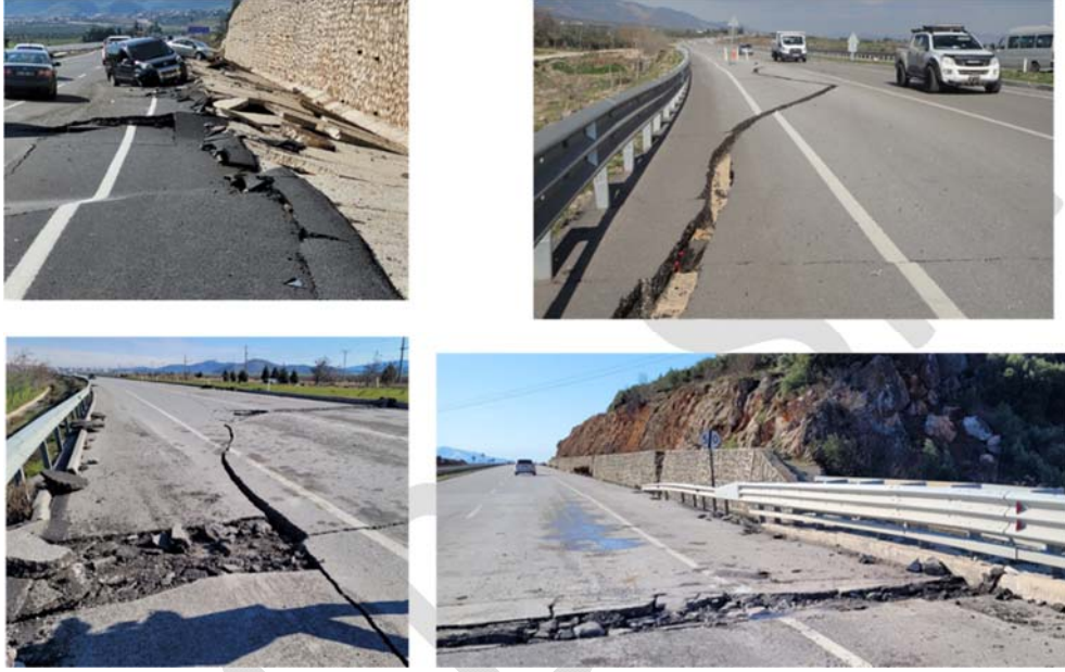
Şekil 35 - Karayollarında depremin ilk günlerinde ortaya çıkan deprem hasarı
