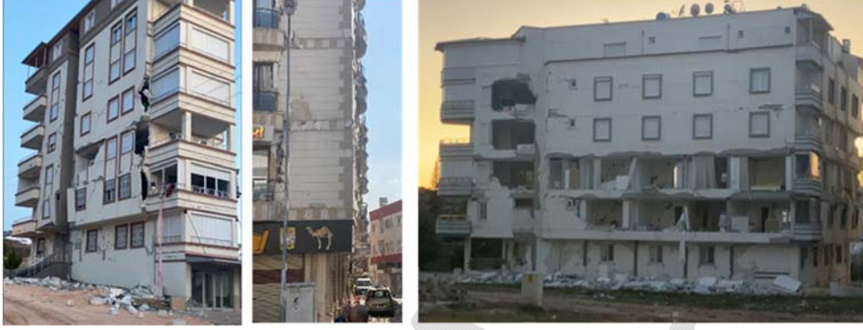
Şekil 19 - Dolgu duvarların düzlem dışı davranışına bağlı yapısal olmayan hasarlar
