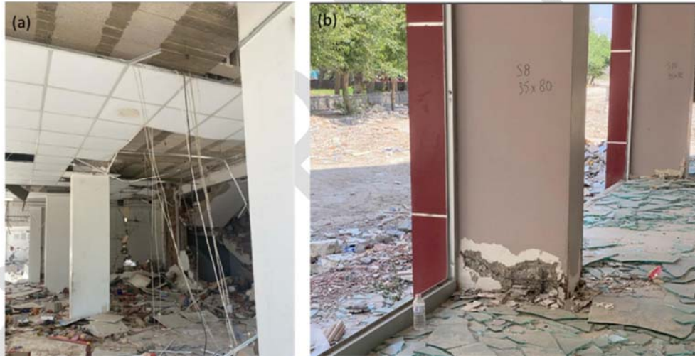
Şekil 26 - (a) Asmolen döşeme hasarı (b) Yapısal düzenleme sonucu oluşan kolon hasarı
