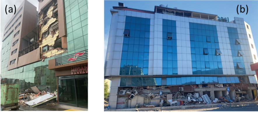
Şekil 27 - 6 Şubat Pazarcık depreminden sonra kullanılamaz hale gelen (a) Megapark ve (b) Vatan Hastaneleri
