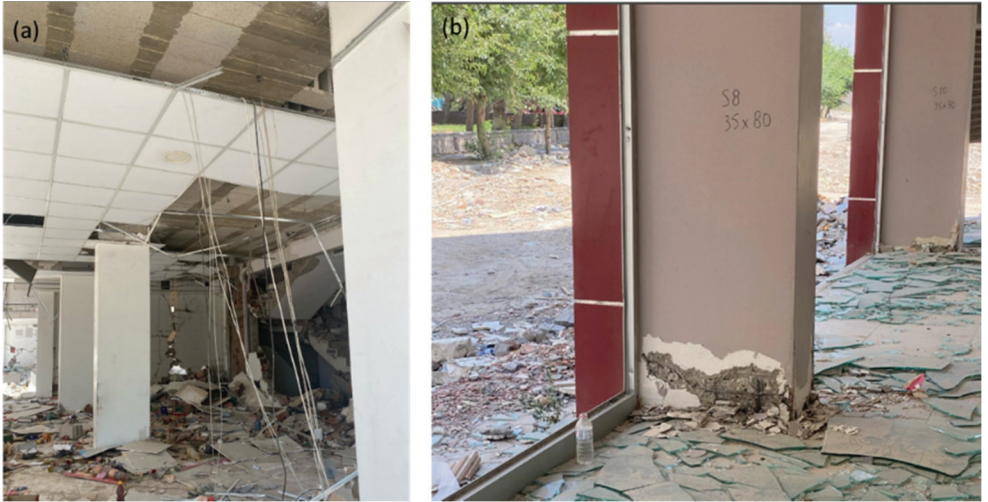
Şekil 26 - (a) Asmolen döşeme hasarı (b) Yapısal düzenleme sonucu oluşan kolon hasarı
