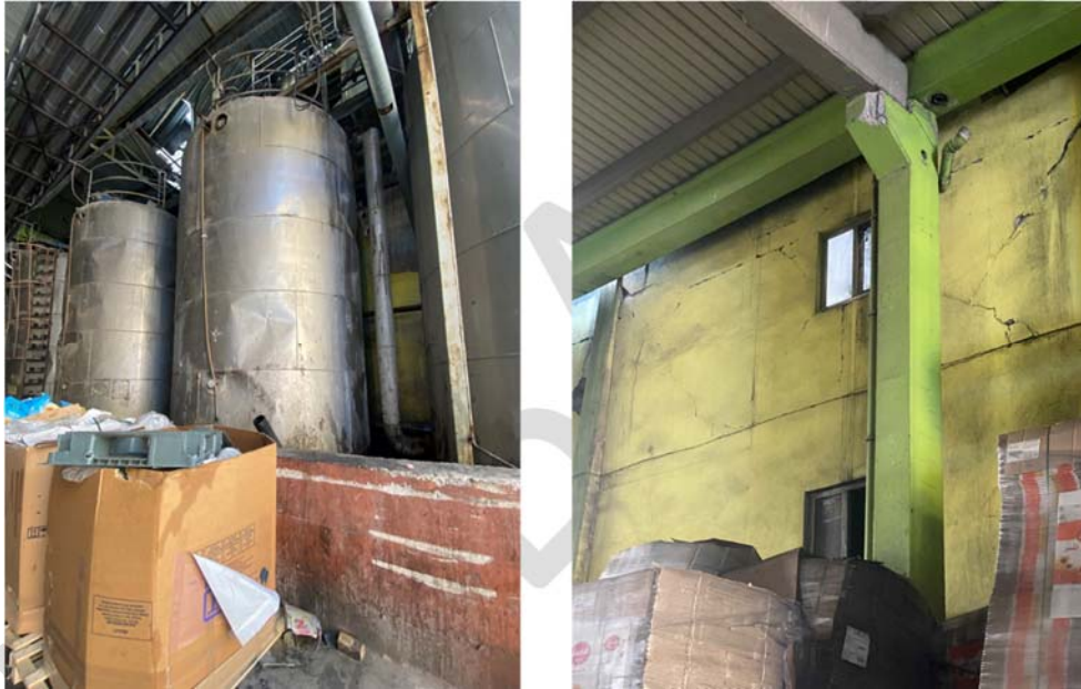
Şekil 39 - Endüstriyel tesislerde silolar ve precast elemanlarda gözlemlenen deprem hasarları
