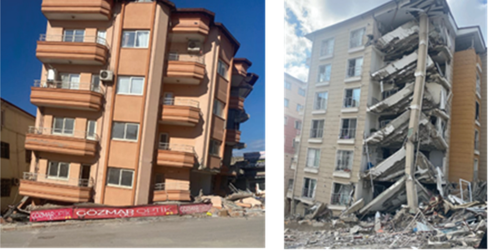
Şekil 23 - Hatay'ın Kırıkhan ilçesinde yumuşak kat hasarı ve binalarda toptan göçme
