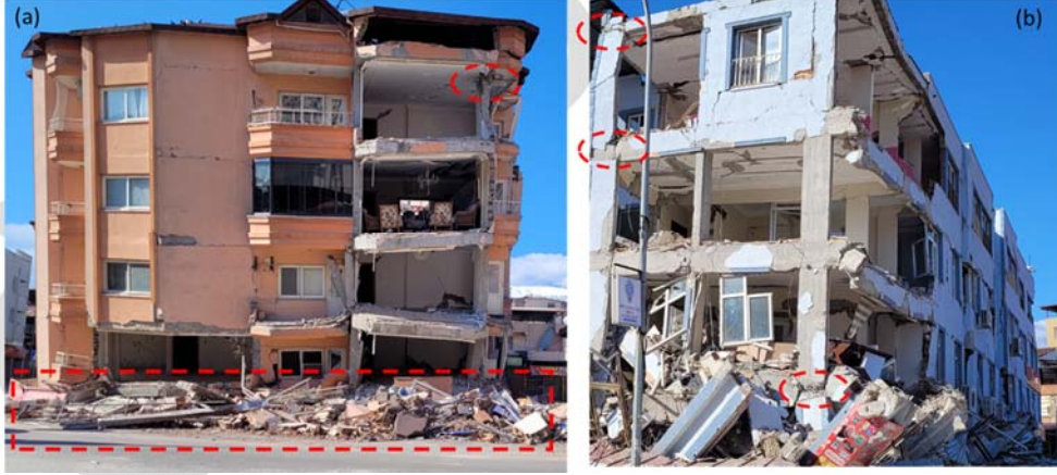
Şekil 24 - Hatay Kırıkhandaki yumuşak kat hasarı ve toptan göçmeye maruz kalan binalar
