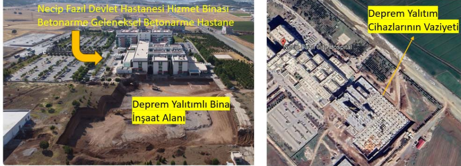
Şekil 30 - Kahramanmaraş ilinde inşası devam eden deprem yalıtımlı hastane binasının inşaa süreci( Fotoğraflar TIS firması izniyle firmanın proje kataloglarından ve uydu görüntülerinden alınmıştır)
