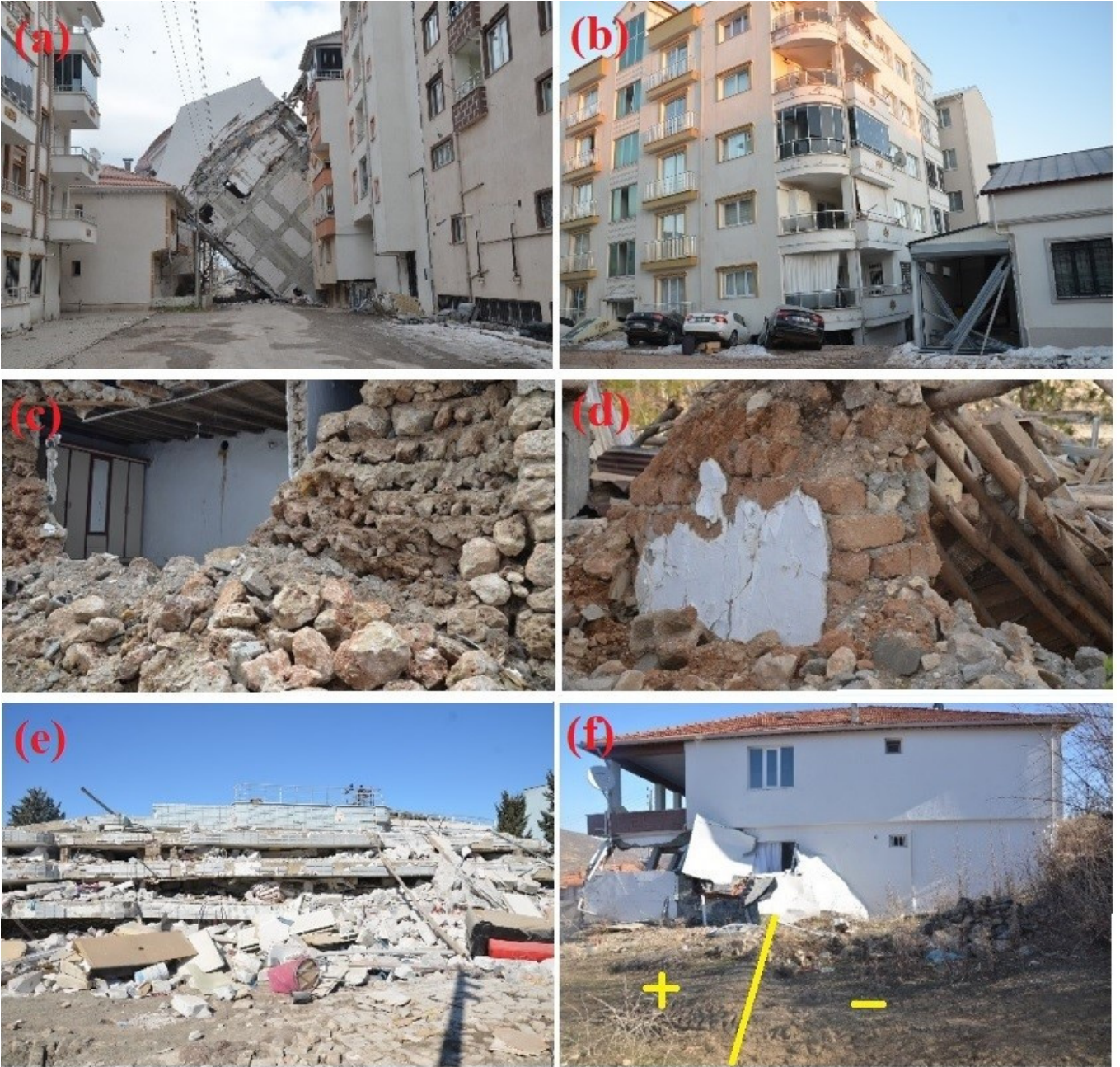
Fotoğraf 3. Yerleşmelerde yıkılan ve hasar gören binalar: Sivilleşme nedeniyle binaların devrilmesi (a) ve zemine batması (b), Ozan yerleşmesinde yığma taş bina (c), Harmanlı'da yıkık kerpiç ev (d), Gölbaşı merkezde taşıyıcı unsurların dağılması ile yıkılan bir bina (e), Karaburun'da fayın üzerine inşa edilen ve faydan etkilenen betonarme bina (f).
