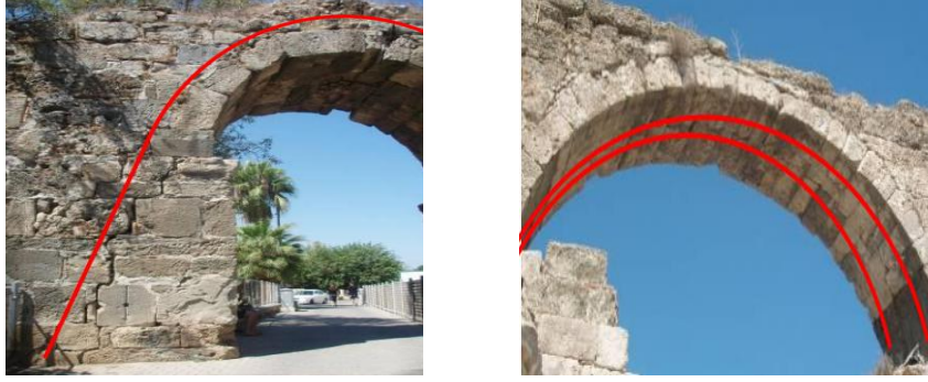
Şekil 8. Yerçekimin etkisiyle kemerlerde oluşan çatlaklar
