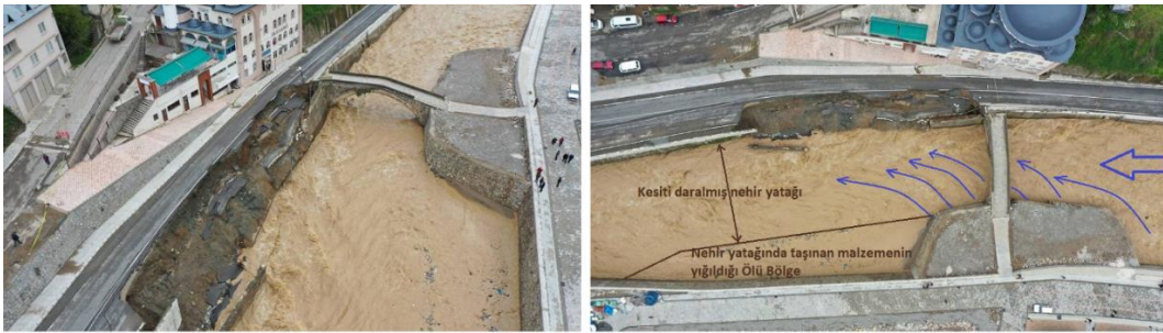
Şekil 11. 2022 yılında meydana gelen taşkın sonrası yolda oluşan çökmeler (URL-6, 2022)
