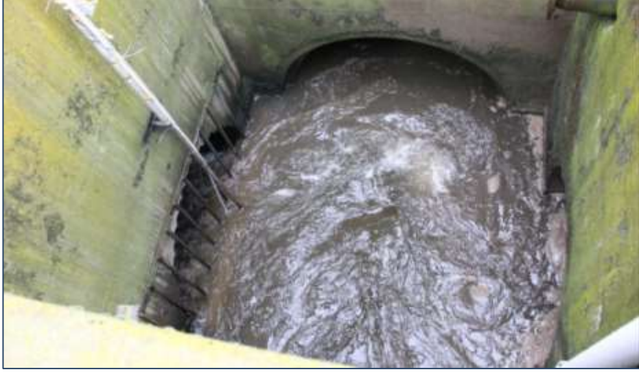
Fotoğraf 10: Atıksular Paşaköy İleri Arıtma Tesisinde Arıtıldıktan Sonra Çayağzı Deresi'ne Verilmektedir
