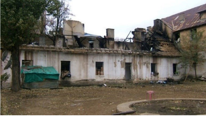
Şekil: 8 Yangın sonrası kışla binasının çatısında oluşan tahribat, 2010 (Tunceli Kent Müzesi Fotoğraf Arşivinden erişilmiştir.)
