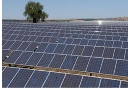
Şekil 5. Kayseri Şeker Fabrikasının Güneş Enerji Santrali [13]
