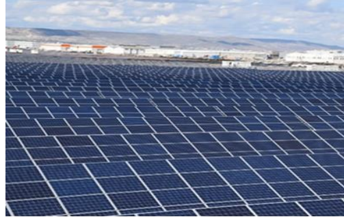
Şekil 6. Kayseri OSB Güneş Enerji Santrali [14]
