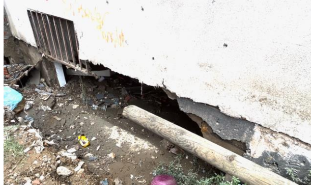
Şekil 7. 2023 Eylül İstanbul seli sonrası tespit edilen bodrum katı cephe hasarı
