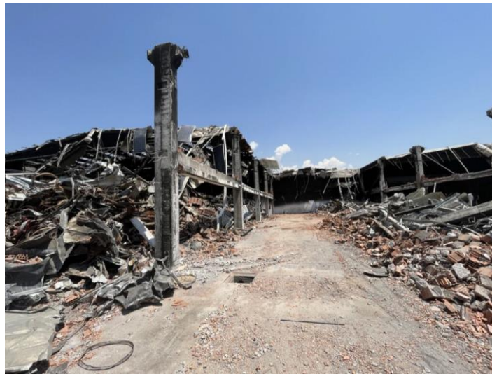
Şekil 4. Bir prekast betonarme sanayi tesisinde deprem sonrası yangın hasarı örneği
