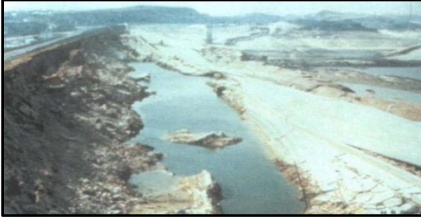
Şekil 5. Deprem (1971) sonrası The Lower San Fernando Barajında oluşan akma (Alpaslan, 2013)
