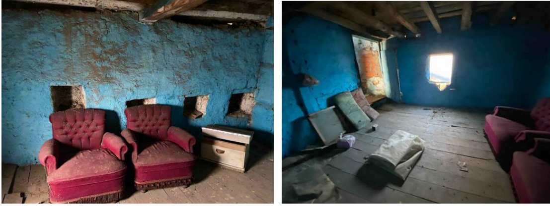
Şekil 8. Ara Kat 101 Nolu Odadaki Bozulmalar [9]
