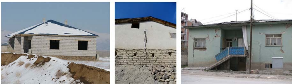
Şekil 12. Hatıl kullanılmamasından kaynaklı hasarlar.
