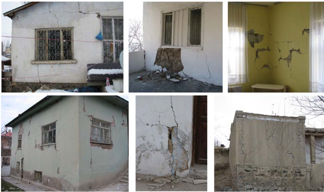
Şekil 23. Düzlem içi davranış hasarları.
