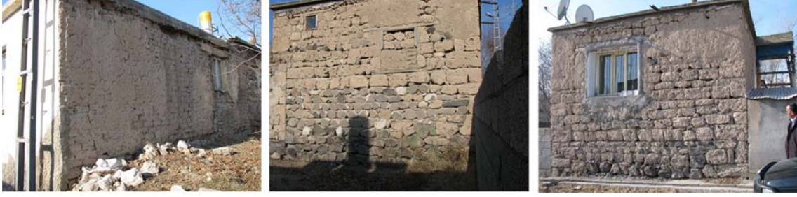
Şekil 17. Dış sıvası düşmüş yığma yapılar.
