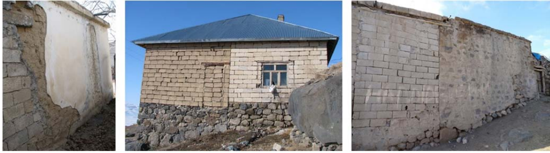
Şekil 21. Birden çok malzeme kullanılmasından kaynaklı hasarlar.
