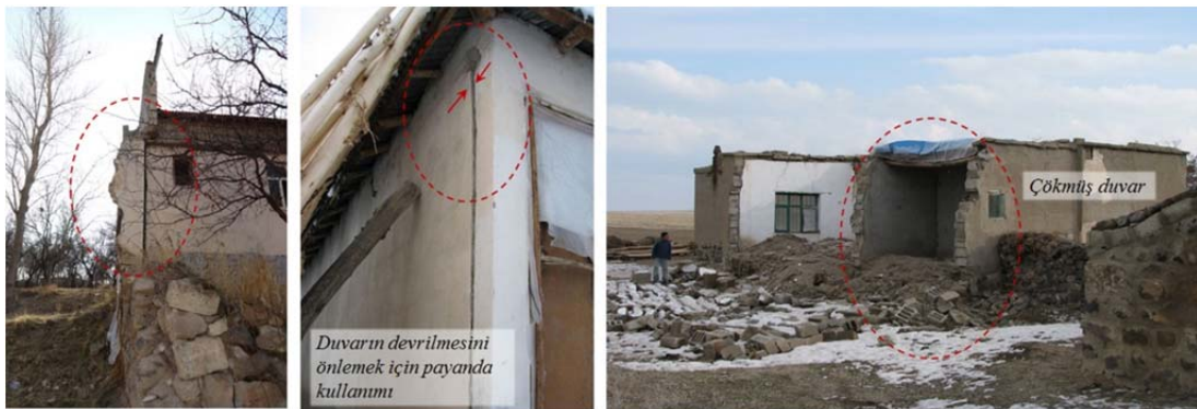
Şekil 16. Duvarların ayrılmasından kaynaklanan hasarlar.
