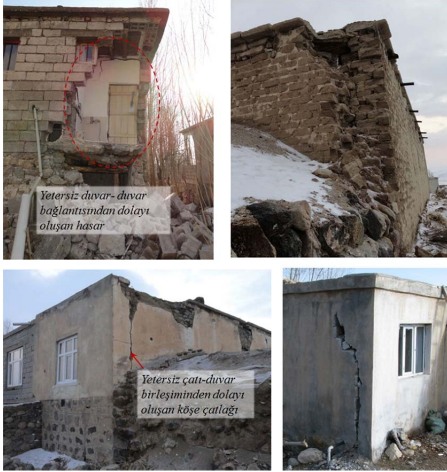
Şekil 15. Köşe birleşimindeki hasarlar.
