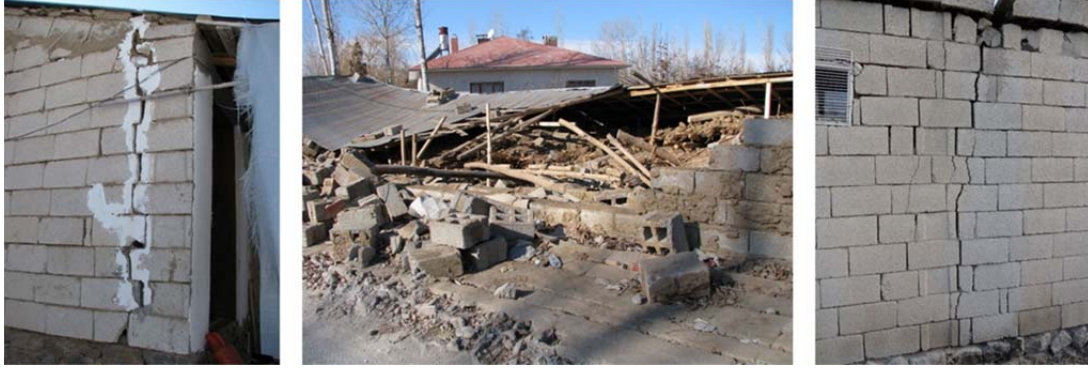
Şekil 7. Delikli kil tuğla kullanımından kaynaklı hasarlar.
