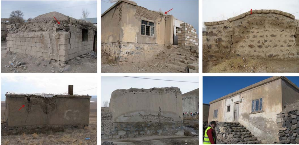
Şekil 9: Ağır toprak çatı kullanımından kaynaklı hasarlar.
