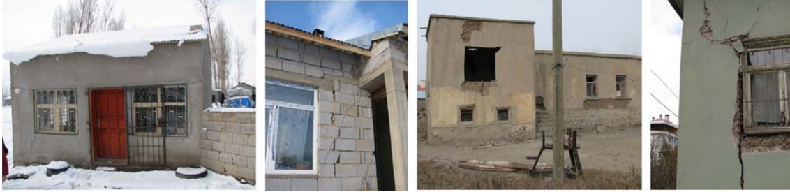
Şekil 19. Boşluklar ve taşıyıcı duvarların desteklenmeyen uzunluklarına bağlı hasarlar.
