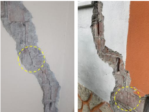
Şekil 12. Düşük dayanımlı yığma birimler nedeniyle meydana gelen hasarlar
