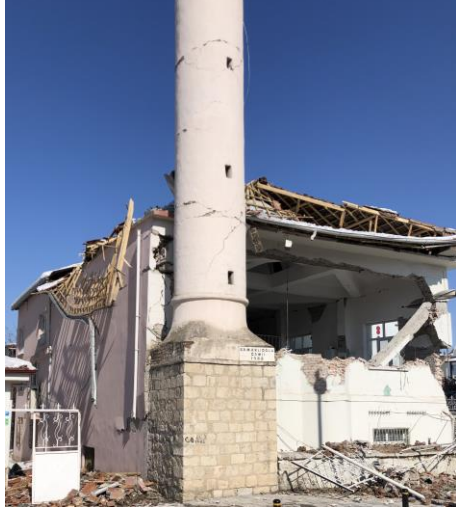
Şekil 7. Düzlem dışı davranış hasarları
