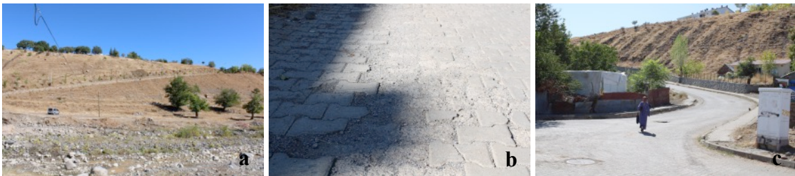
Şekil 6. (a) Çapakçur Vadisi'nden Karşıyaka'ya çıkış, (b) Döşeme malzemelerindeki bozulmalar, (c) Eski Saray Caddesi'nden Merkez'e çıkış
