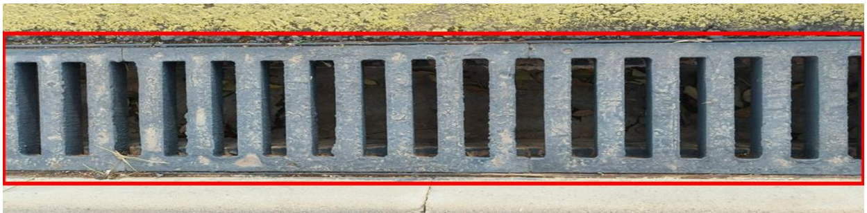
Şekil 5: Izgara açıklığı ile standartlara uymayan yağmur suyu drenaj ızgaraları (Orijinal, 2023)
