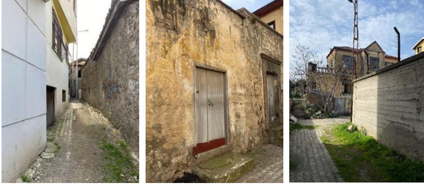
Şekil 18. Tarihi duvarlara grafiti (Vandalizm) / Uygun olmayan betonarme duvar. (Tez kapsamında yapılan alan çalışması, 2023)
