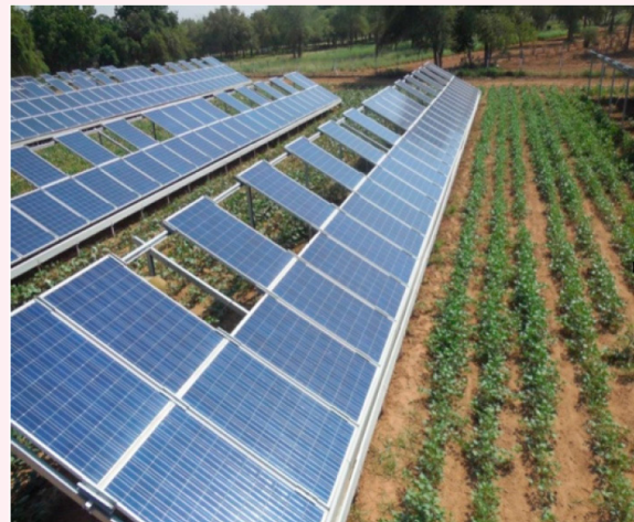
Şekil 7. Hindistan'ın Jodhpur'daki yere monte uygulaması
