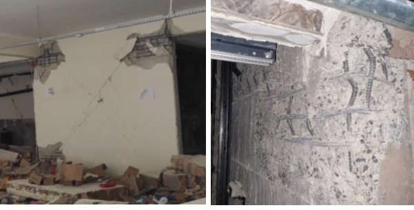
Şekil 7. Perde gövde kesme ve uç bölgesi ezilme hasarı
