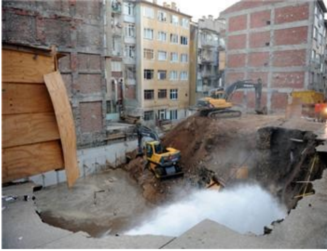
Şekil 33. Bursa Osmangazi’de yaşanan göçük
