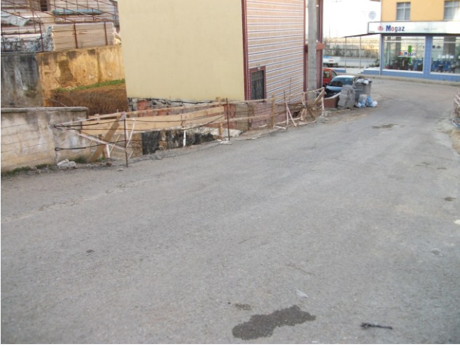
Şekil 18. Temeline teğet kazı yapılmış bina
