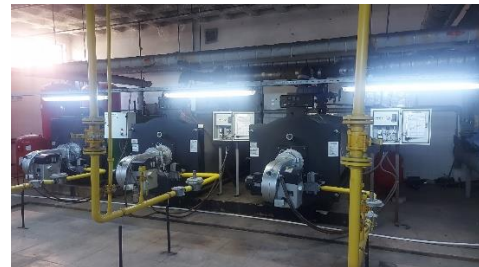
Şekil 1. İncelenen sıcak su kazanının bulunduğu kazan dairesi görüntüsü (En sağdaki incelenen kazan)
