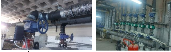
Şekil 2. İncelenen kazanının sıcak su dağıtım kanalları
