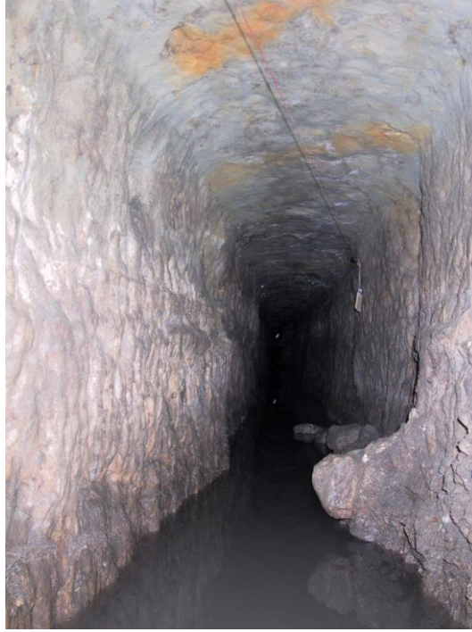
Resim 12: Troya sırtının batı yamacındaki su toplama tüneli, duvarlardan sızan sular birikmekte ve dışarı akmaktadır (Troya Kazı Arşivi)
