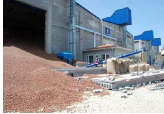
Şekil 4.1. Bunker sistem fındık silosunda yan duvar başarısızlığı
