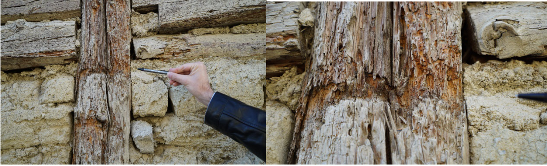
Şekil 14.b Ahşap yapı elemanlarında görülen bozulmalar
