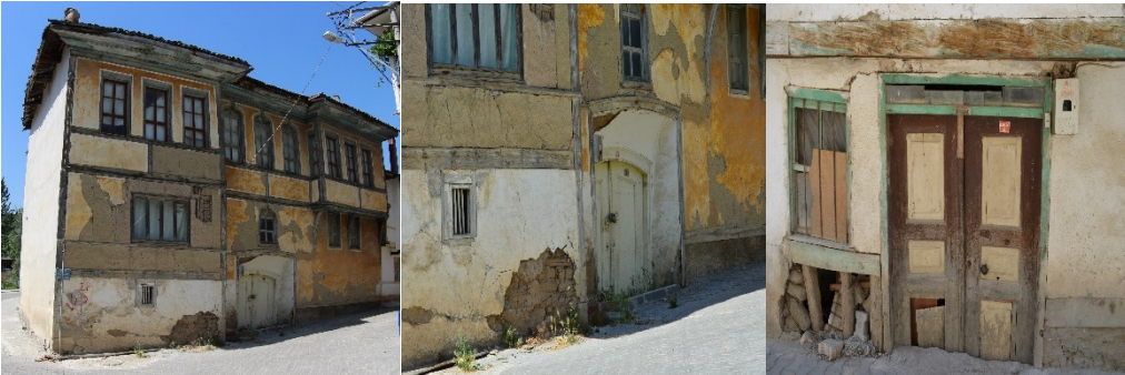
Şekil 15. Zeminde sonradan oluşan kot farklılığı
