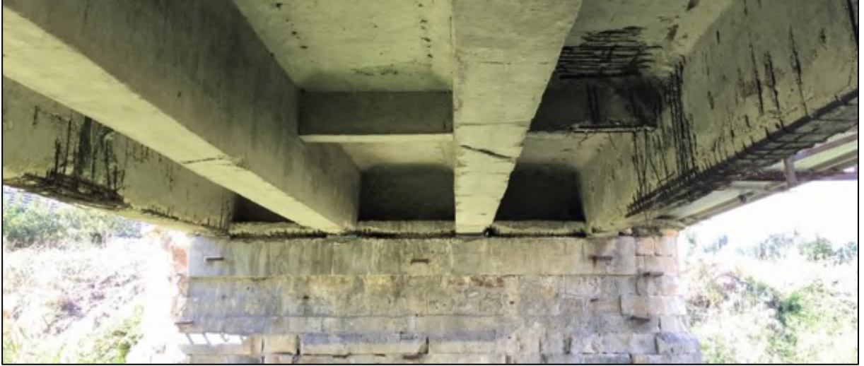
Resim 21. Köprü Kirişlerindeki Bozulmalar
