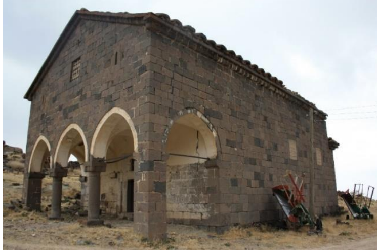
Şekil 10. Niğde Ballı Köyü Kilisesi, Derin Çatlak [18]
