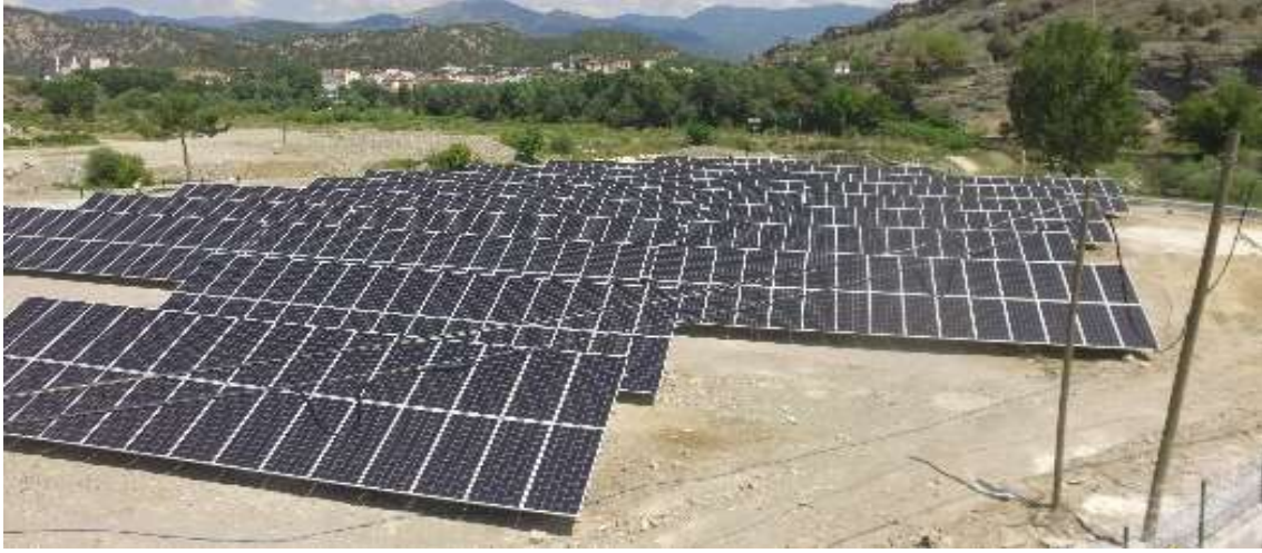
Şekil 6. Hanönü (Kastamonu) güneş enerjisi santrali kurulu hali.
