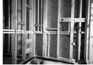
Şekil 10. Tesisat işlemleri yapılmış bir iç mekan
